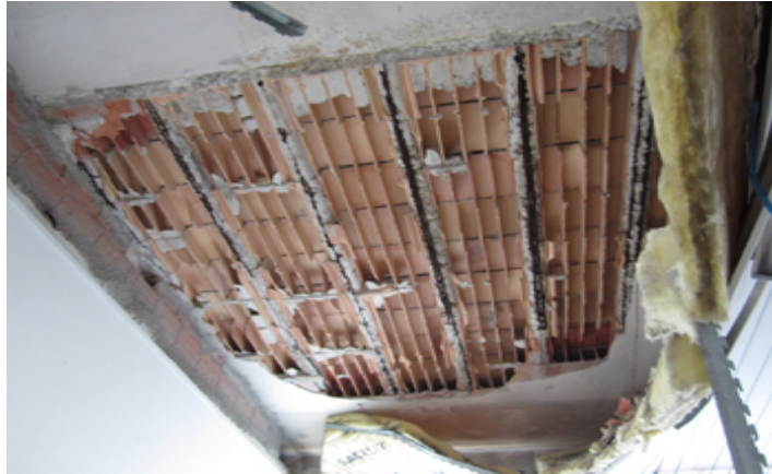
Fig.1 - Esempio di sfondellamento di solai.
