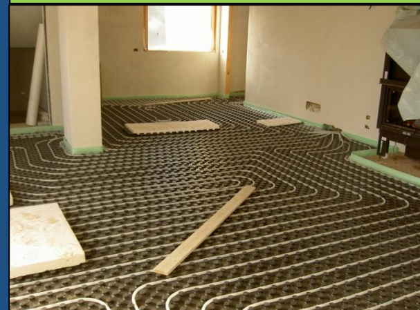
Riscaldamento a pavimento piano terra
